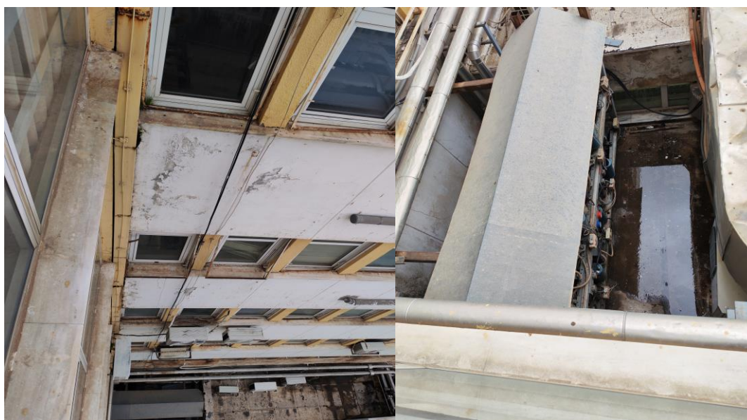
Φώτο (1): Όδευση υδρορροής & αγωγός καθόδου αλεξιεύρανου
