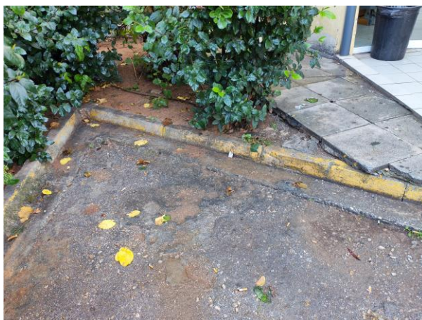
Φώτο (6): Ελεύθερη απορροή στο ρείθρο του πεζοδρομίου
