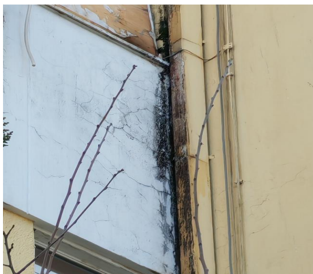
Φώτο (4): Φθορές επιφανειών και όδευση ηλεκτρικών καλωδίων
