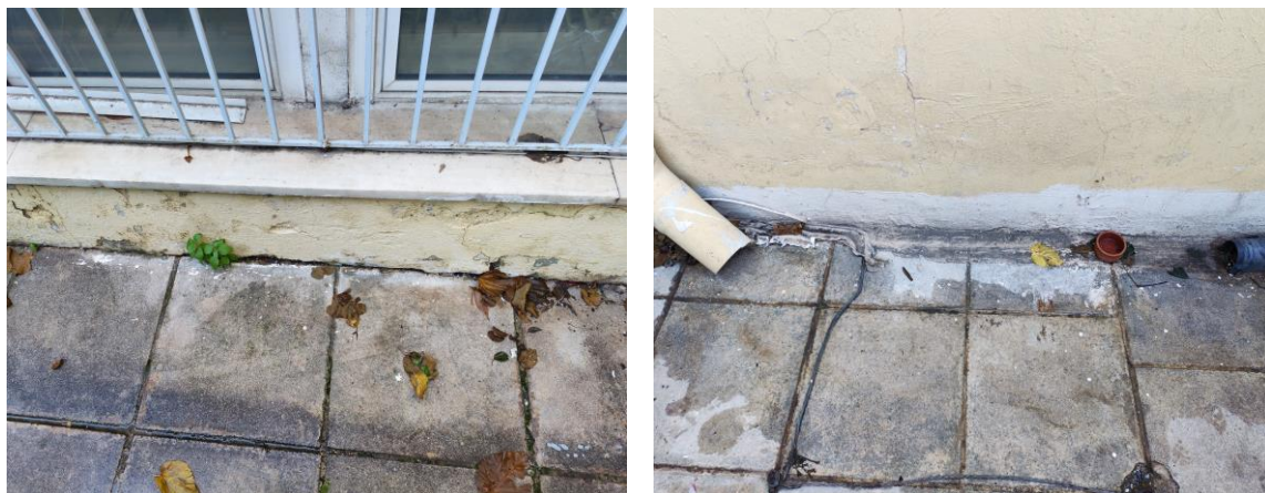
Φώτο (5): Υφιστάμενος αρμός στη συμβολή του κατακόρυφου τοίχου με το οριζόντιο δάπεδο
